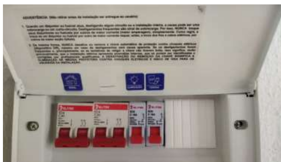
Figura 6: Distribuição dos disjuntores no interior do quadro.
