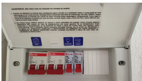
Figura 6: Distribuição dos disjuntores no interior do quadro.
