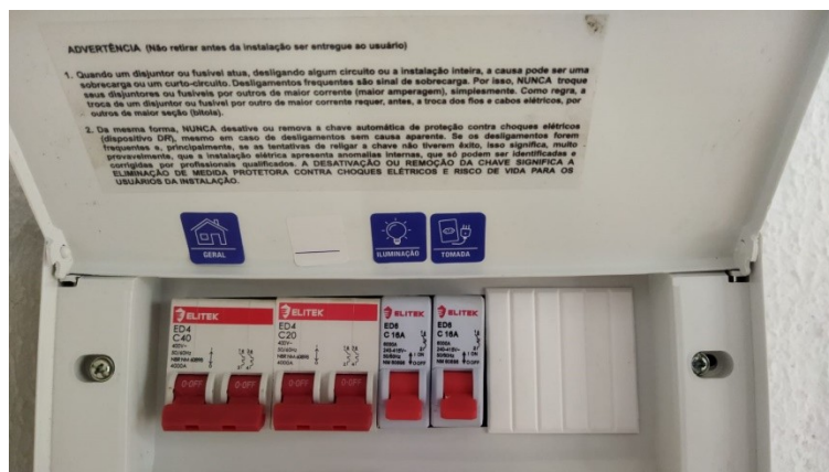
Figura 6: Distribuição dos disjuntores no interior do quadro.
