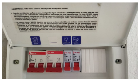
Figura 6: Distribuição dos disjuntores no interior do quadro.
