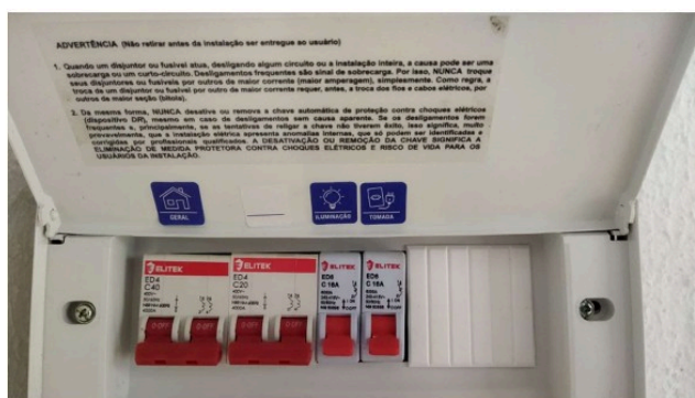
Figura 6: Distribuição dos disjuntores no interior do quadro.
